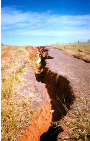
Figura 05- Lotes Urbanizados: aspectos degradantes da infra-estrutura.
